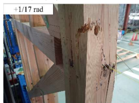
(b) 柱の曲げ破壊
