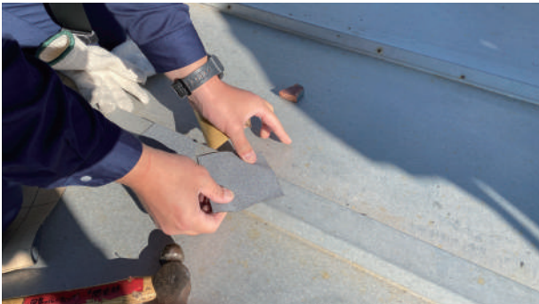
図6. 改質アスファルト片面粘着シートを用いた工法 （撮影：被災屋根応急補修工法開発研究会）
