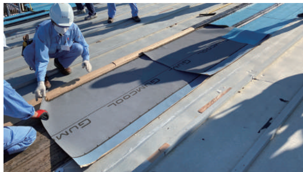
図4. 改質アスファルト片面粘着シートを用いた工法（撮影：被災屋根応急補修工法開発研究会）
