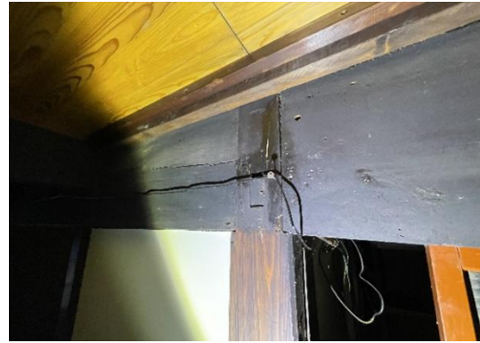
図3 柱の折損（中町家主屋） 折損による亀裂が生じているが 見えづらく見落とす可能性あり
