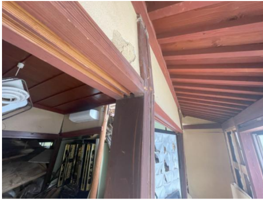
図2 柱の折損（木村家主屋） 折損による亀裂が確認できる 柱の傾斜も 1/10 程度と大きい
