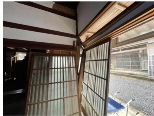
図5 柱の折損（疋田家主屋） 二階が載る部分の隅柱とともに同じ筋の 全ての柱が折損したため応急補強を実施
