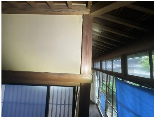
図4 柱の折損（七野家へや） 長押があるため亀裂が確認できないが 鴨居上下で柱の傾斜角が大きく変化
