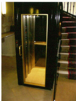
1) 古いアパートマンの階段室吹抜け設置用小型E Vの事例
