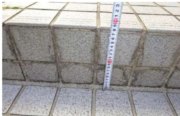
階段段差蹴上 (D)
