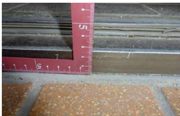
玄関入口段差 (F)
