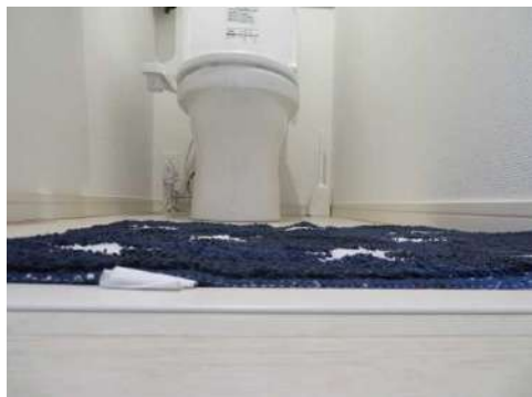
No.35 トイレと廊下の段差
