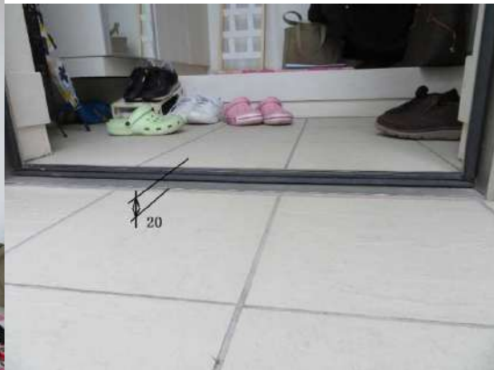
No.17 玄関出入口段差
