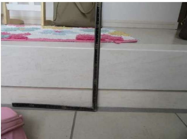
No.18 上がり框段差
